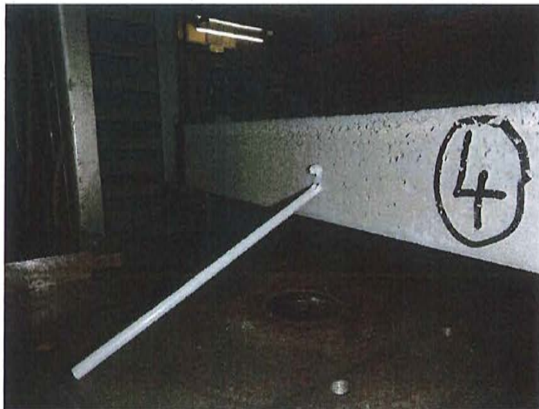
Bild 10: Bruchbild GFK-Dübel – Abscheren / Bruch Dübel
