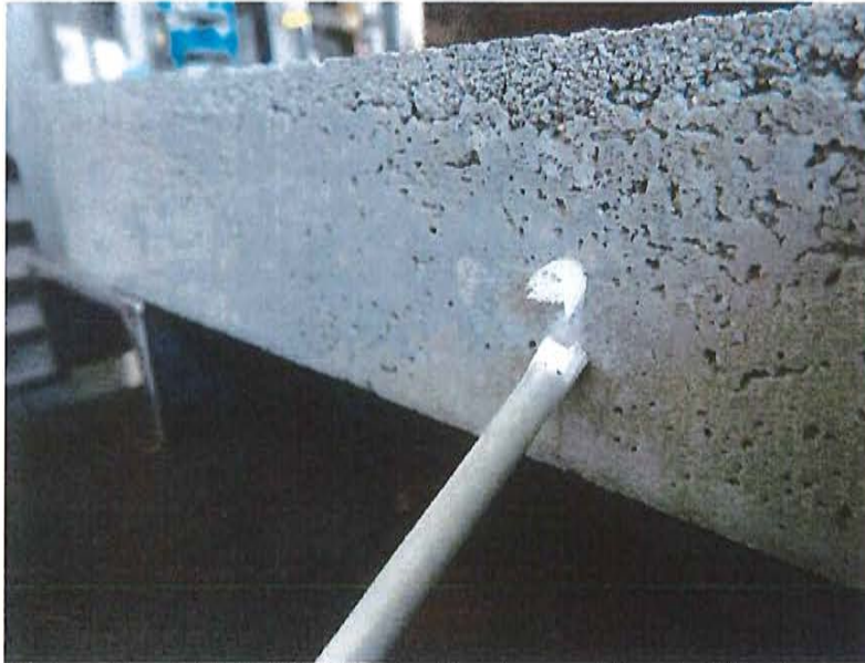
Bild 11: Bruchbild GFK-Dübel – Abscheren / Bruch Dübel
