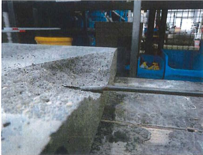
Bild 9: Bruchbild Metalldübel – Ausbruch Mörtel
